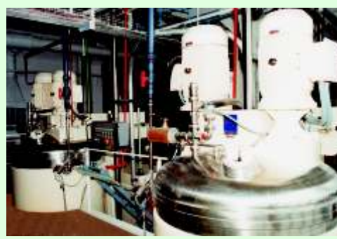
Процессорная установка «FRYMA» для приготовления косметических масс
